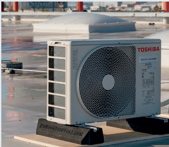
PADO Shopping Galerien Parndorf, CAVERION Österreich GmbH Klimaanlage und Wärmepumpen
